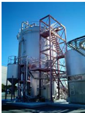
メタン発酵施設
